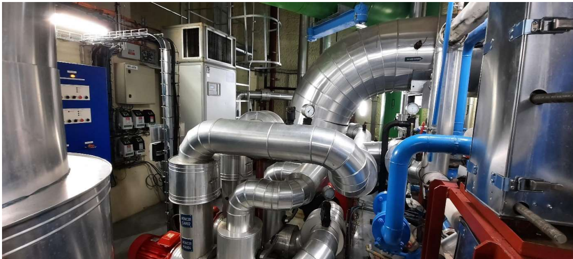
Vue générale d'une salle des machines de la centrale de froid Canada, similaire à celle qui sera construite au sous-sol du bâtiment EDA.
